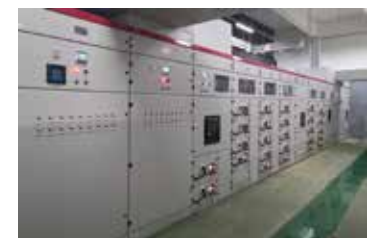
配电网无功倒送检测
